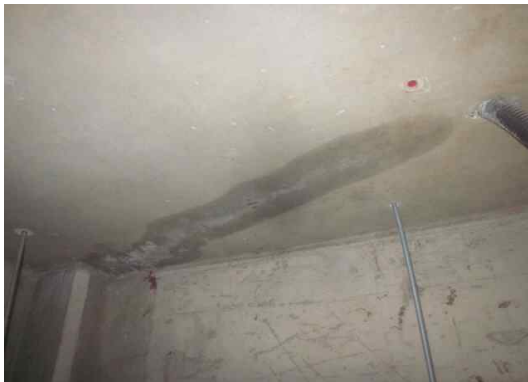
슬래브 균열 및 누수흔적
