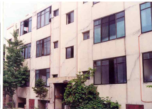
부동침하에 의한 경사균열
