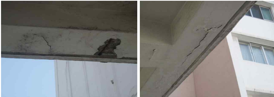
철근부식 의한 콘크리트 박락
